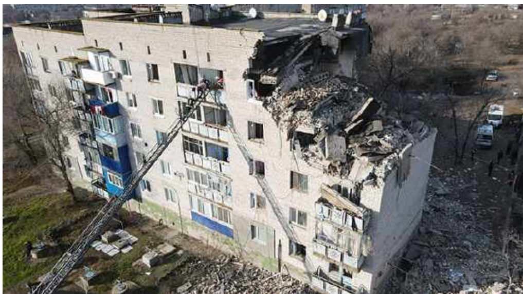
Рис. 1. Результати аварії після вибуху природного газу в житловому будинку, м. Нова Одеса Миколаївської обл.
