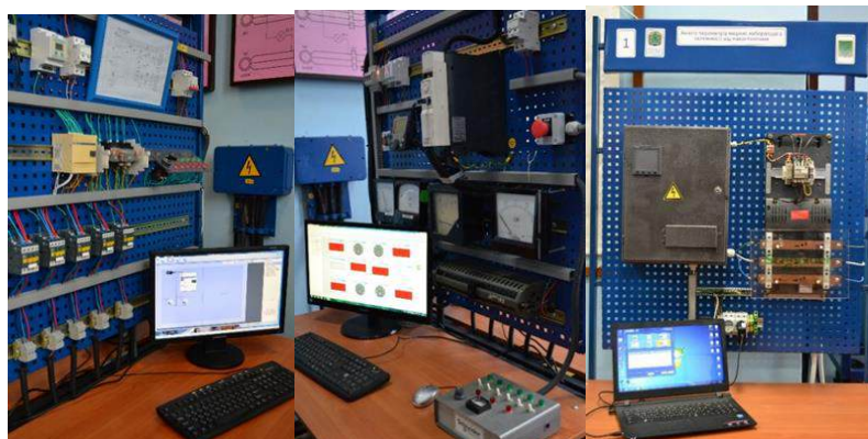
Рис. 3. Електронні пристрої для керування електроприводами
