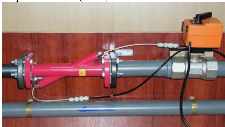
Рисунок 1 – Загальний вигляд фрагменту теплового пункту
